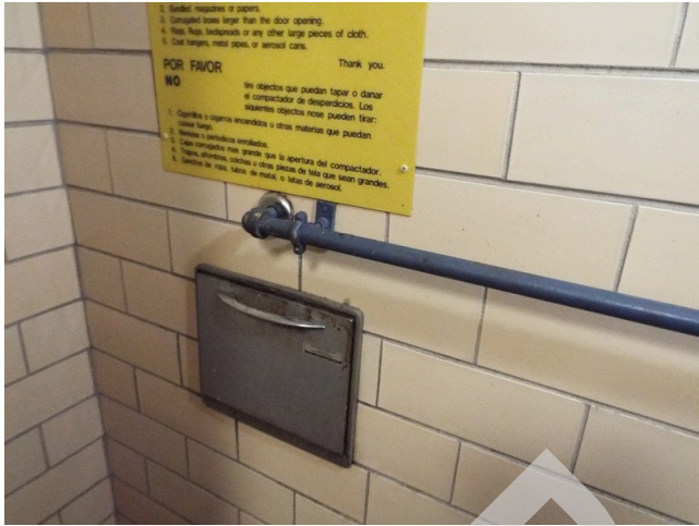
185. Trash chute door
